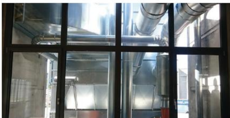
L'installation comporte deux réseaux, un réseau basse pression, et un réseau haute pression.
